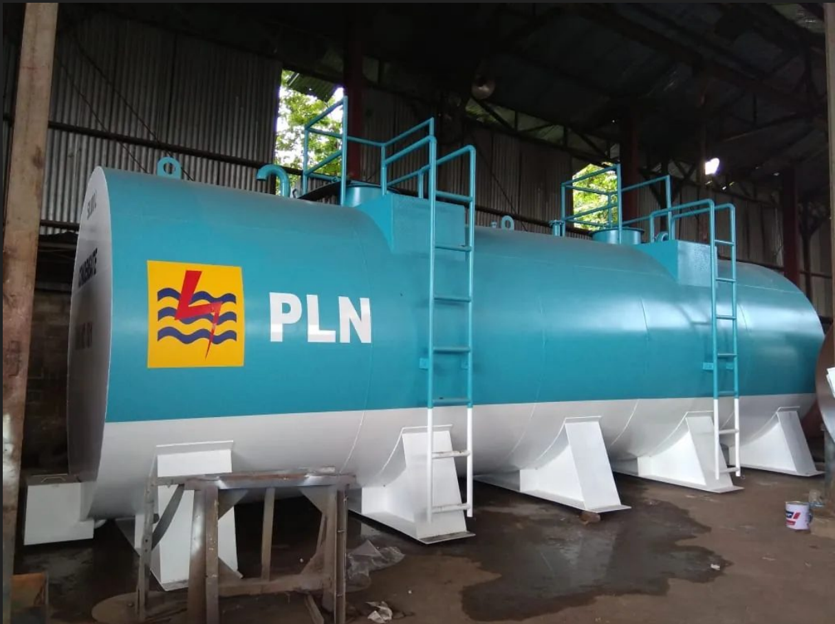
Tangki PLN 50 kL - dokumentasi perusahaan.
